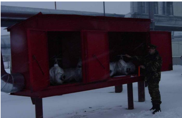
Рис. 3. Надземный пожарный гидрант в укрытии, северного исполнения (так называемое укрытие на 4 патрубка), по п. 6.16 ВНТП 03/170/567
