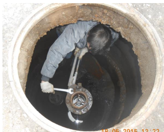
Рис. 8. Колодец подземного пожарного гидранта
